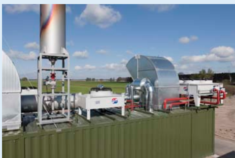
Устройство слева: Сухой охладитель Güntner GFH в качестве охладителя смеси; устройство справа: сухой охладитель Güntner GFH в качестве резервного охладителя, который может использоваться во время работ по техническому обслуживанию ВНКВ.
