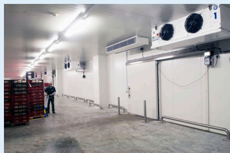
Воздушный охладитель GGHN в холодильном складе
