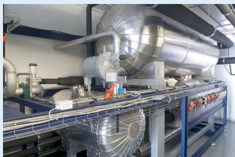
Автоматическая установка NH 3 /CO 2 в контейнере
